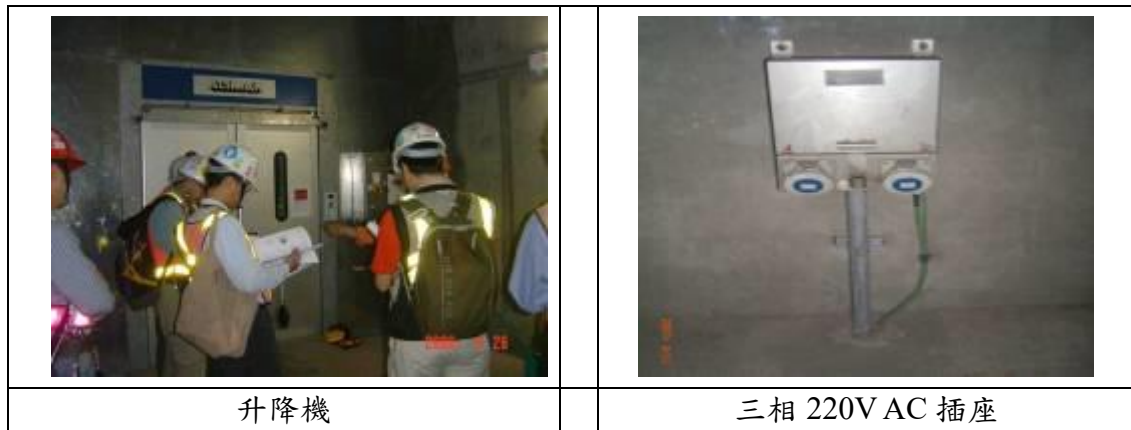
圖 3-1 高鐵長隧道段之消防與救災設施實景
