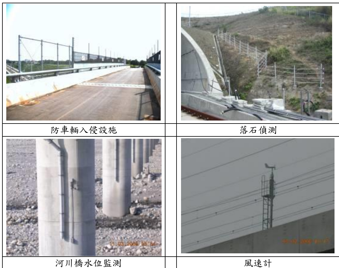
圖 3-4 高鐵天然災害偵測系統與預警系統實景
